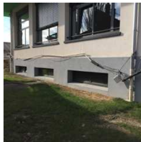
Les câbles sur le côté de l'agence
