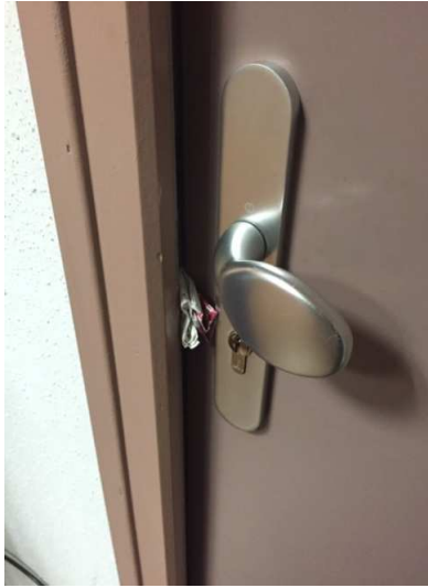
Le problème de gâche électrique
